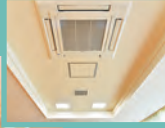
食堂の空調室内機
