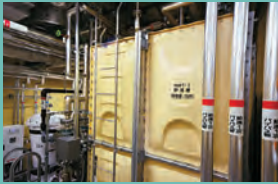
貯湯槽(総容量15トン)
