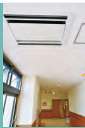
廊下の空調室内機
