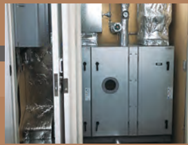
空調機を介して 床吹き出しユニットへ
