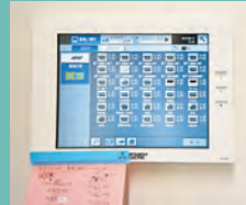
支援員室にある空調の集中管理パネル
