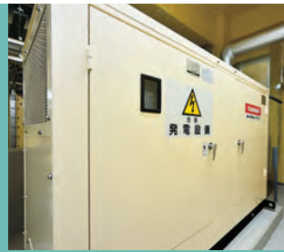
緊急時に備えた自家発電設備
