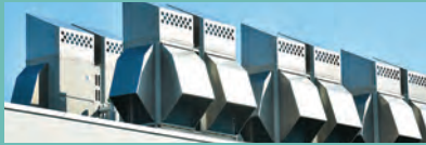
パッケージエアコン 室外機
