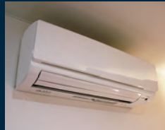
各客室に設置したエアコン室内機
