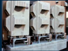
ヒートポンプ給湯室外機
