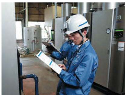
蒸気ボイラの台数制御も最適化します
