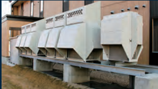
ヒートポンプエアコン室外機
