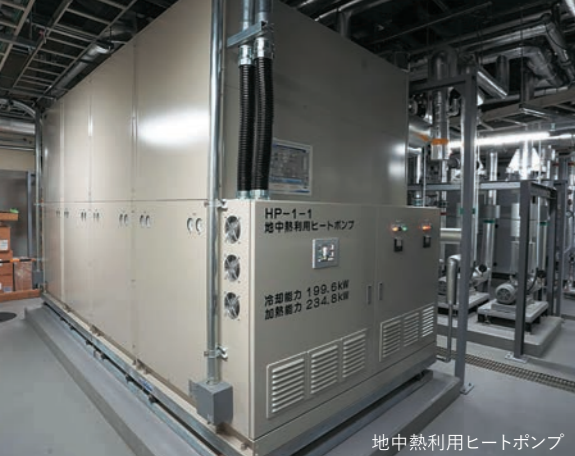
地中熱利用ヒートポンプ
