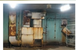
工事前の発茸室空調設備不調が始めて発茸環境が安定しない懸念も。
