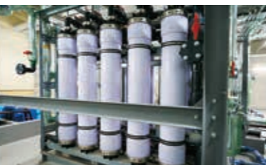
ろ過器・UF膜設備(地下水処理設備) 地下水を汲み上げ処理することで、雑用水や天然芝への散水に利用
