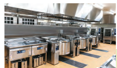
IHフライヤー(左)と電気回転釜
