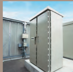
蓄電池を完備し、有事のバックアップ電源に
