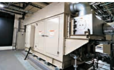
発電設備(CGS) 発電と同時に排熱を暖房や給湯に利用
