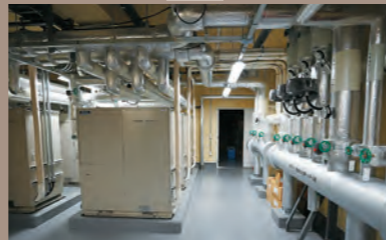
地中熱ヒートポンプを全面採用
