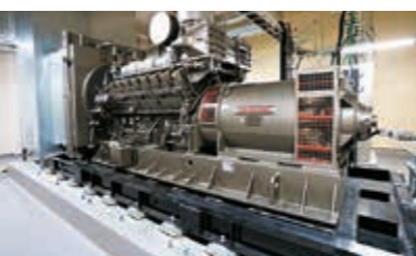
非常用発電機 停電時に防災用設備等に電力を供給
