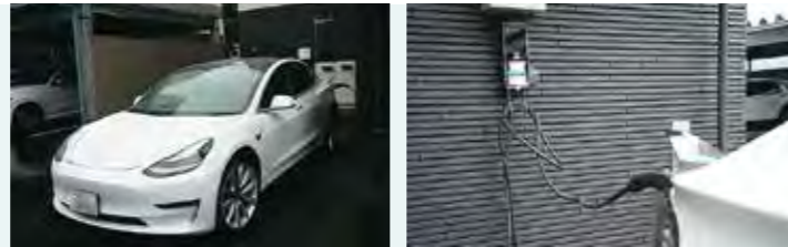
「ジュノール桑園」のEV充電設備
