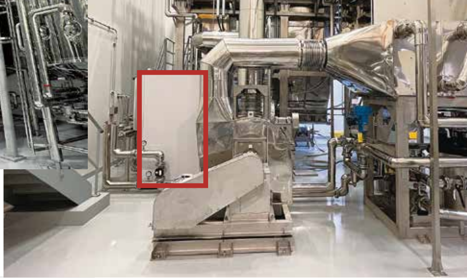
ノンフロン熱風ヒートポンプを使用したハイブリッド乾燥システム 赤枠内がエコシロッコ
