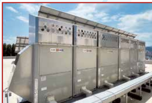
屋上に設置された高効率電気ヒートポンプ空調室外機
