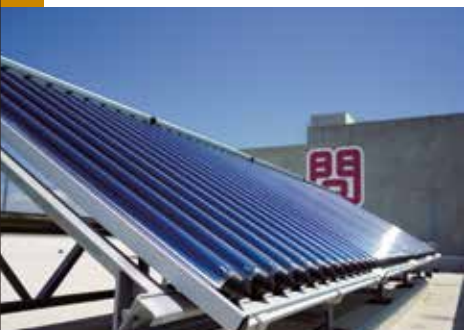
太陽熱集熱器：集熱面積 8.0㎡ (2.0㎡×4台)
