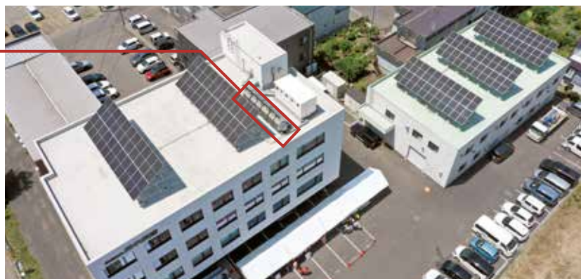
社屋棟と隣接する倉庫棟の屋上に計110枚(49.5kW)の太陽光発電パネルを設置
